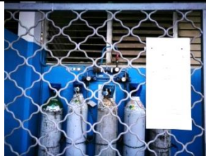
Centrale oxygène (atelier)
